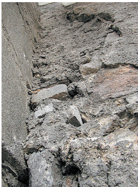
Obr. 8. Český Krumlov, státní hrad a zámek, detail osazení a stav cihelného zdiva okenního arkýře, vybudovaného na kamenných konzolách. (Foto Václav Girs, 2003)
